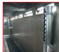
Absaugung des Ölnebels und der Kühlflüssigkeit
